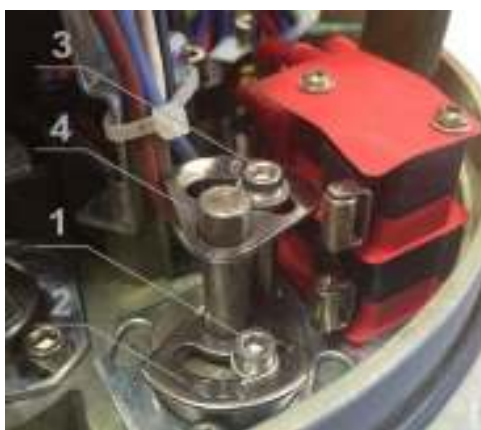
Рис. 5. Блок моментных выключателей
